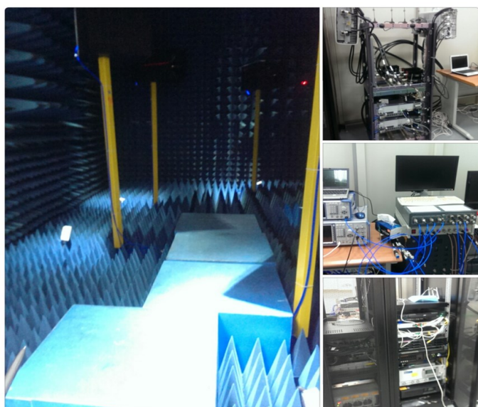
左為 MIMO OTA Test System 之多重路徑電波隔離室；右為 4G/LTE 真實基地台 IOT 測試環境。
